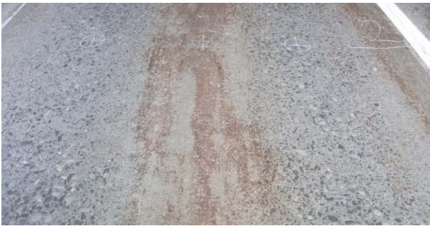
写真-3 除雪車の刃により表面が削られた路面
