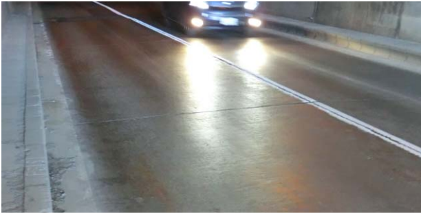
写真-2 光沢を帯びたコンクリート舗装路面
