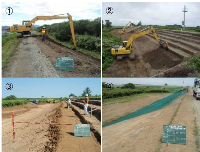
図 2-1 オオイタドリ対策工の施工手順 H20 施工 湧別川 湧別右岸築堤での施工時
