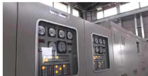
写真-2 機側操作盤
