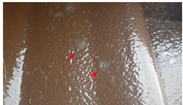
写真-2 第2号落差工気中部の変状
