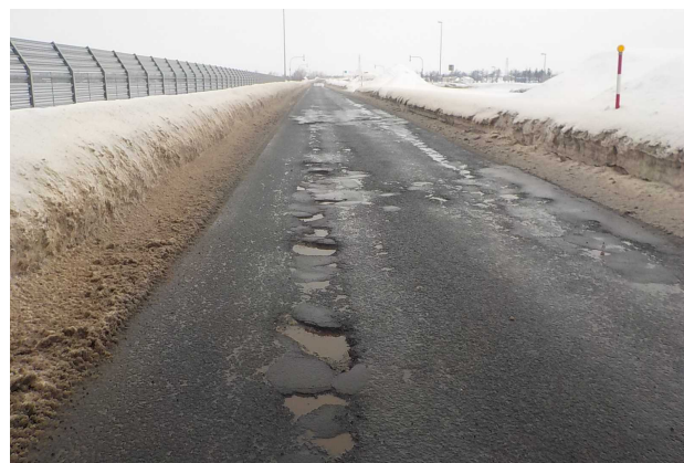
写真-1 ポットホール発生状況
