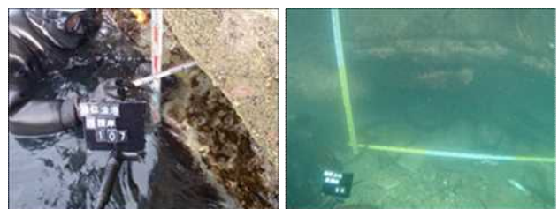
水際付近の欠損
