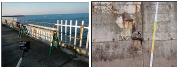
アルミ高欄の欠損状況
