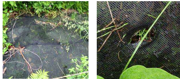
写真-3 シートの浮き上がり(左)、ピンの抜け(右) (撮影日 H30/7/2)
