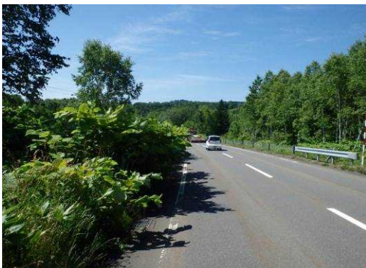
写真-1 イタドリによる視線誘導の障害の状況（国道275号）
