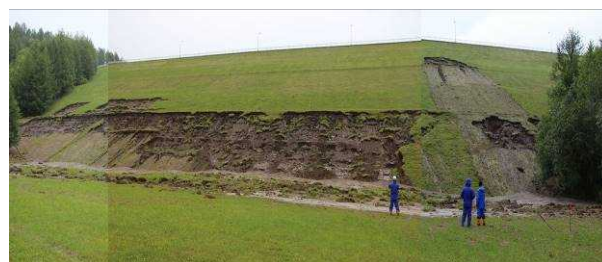
写真-1 堤体下流法面の崩落状況
