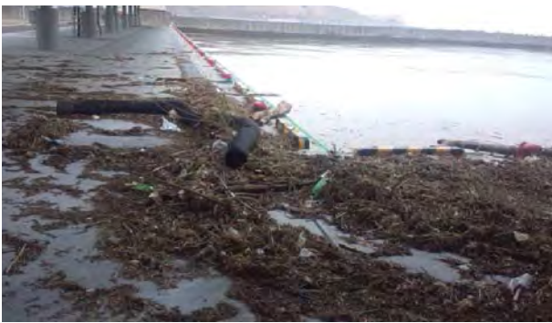
写真-4 低気圧通過後の岸壁状況
