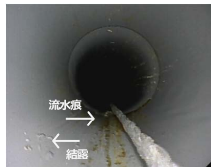
写真-3 管路継ぎ目部から水が流入したとみられる痕
