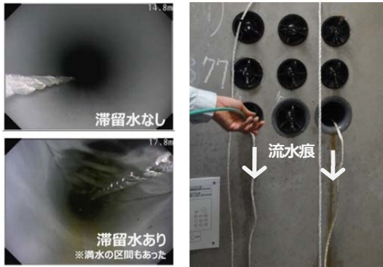
写真-4 左) 通信管路内の滞留水の状況 右) 管路から特殊部への漏水の痕跡
