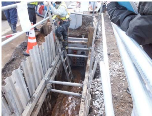
写真-5 掘削地盤内の出水状況
