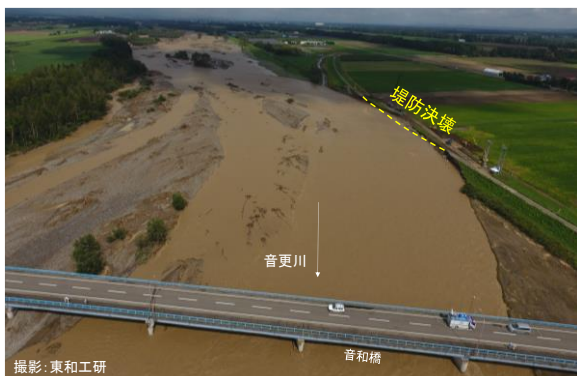
写真-1 音更川 KP21.2 で発生した堤防決壊、平成28年9月撮影、帯広開発建設部提供
