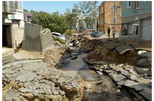
写真-2 住宅街での道路の著しい変状（札幌市 清田区）
