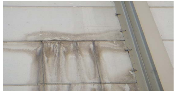
写真-4 内壁漏水跡の状況
