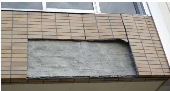
写真-2 外壁タイル落下状況
