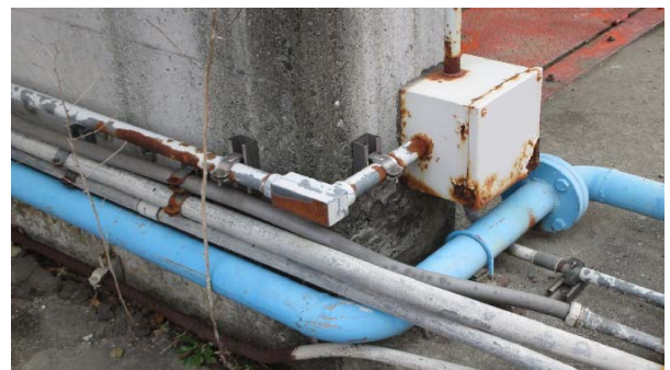
写真-5 電気配管腐食状況
