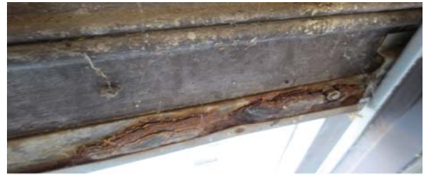
写真-3 シャッターの腐食状況
