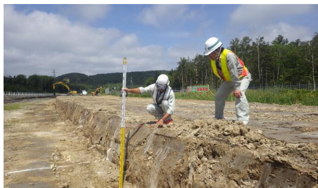
写真-4 盛り上がり土の発生状況
