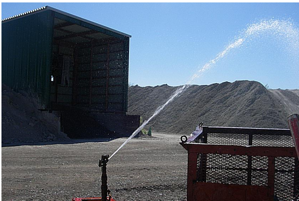
写真3 リサイクル施設の散水設備（構内粉塵防止）
