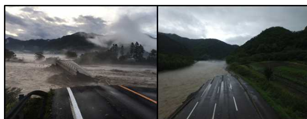
写真-3-2 国道274号日勝峠光ケーブルの断線状況
