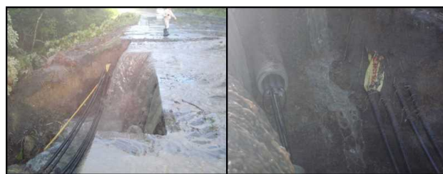
写真-3-1 国道39号石北峠光ケーブル断線状況
