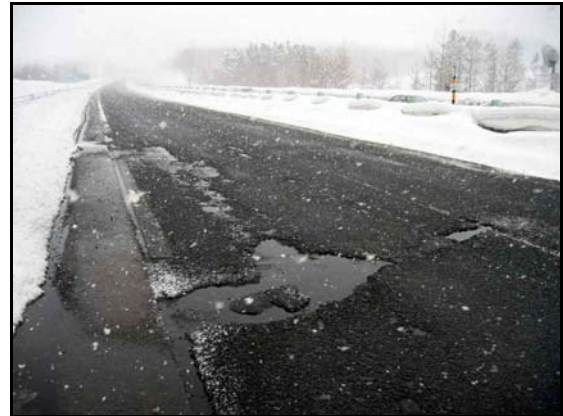
図-1 高機能舗装Ⅰ型の損傷状況
