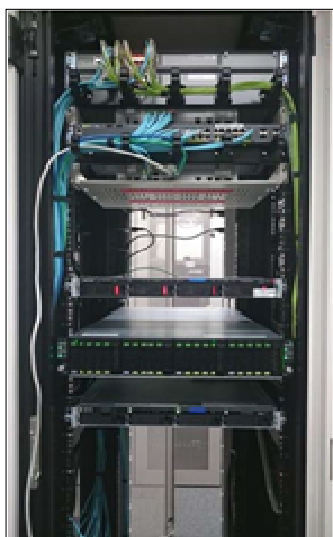
写真-4 仮想化サーバ設置状況
