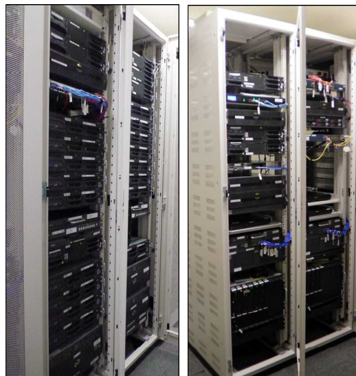
写真-1 サーバ等収容状況
