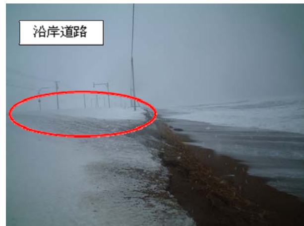
写真-1 沿岸道路への波遡上状況 (平成16年1月15日)
