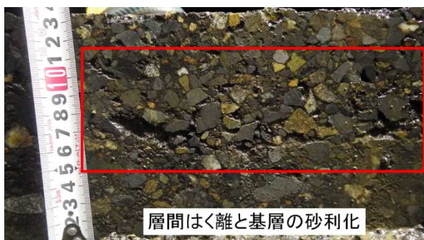
写真-2 排水性舗装供用区間で発生した構造破損
