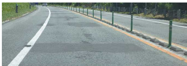
写真-1 排水性舗装の破損状況
