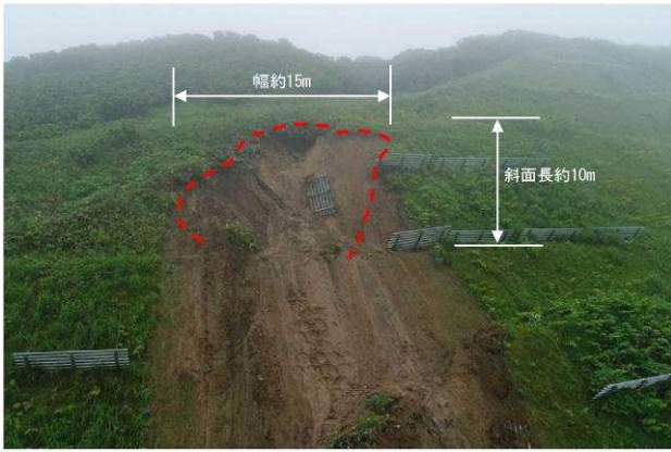
写真-2 崩壊箇所全景
