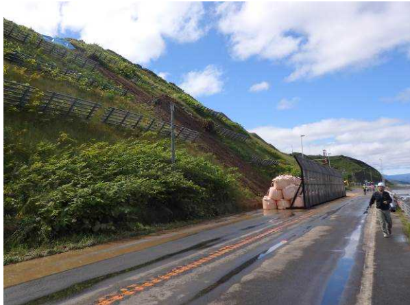
写真-4 通行止め解除後の状況（片側交互通行）
