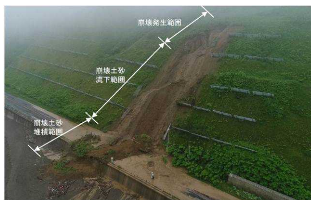
写真-1 被災箇所全景
