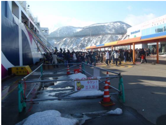
図-2 空洞化箇所の立ち入り禁止状況
