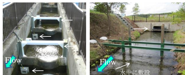
上流アンテナ（4基）
