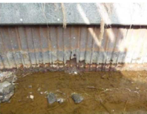
写真-2 気中部の腐食
