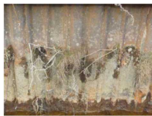
写真-3 錆による腐食
