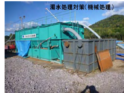
写真-8 濁水処理施設（機械装置）
