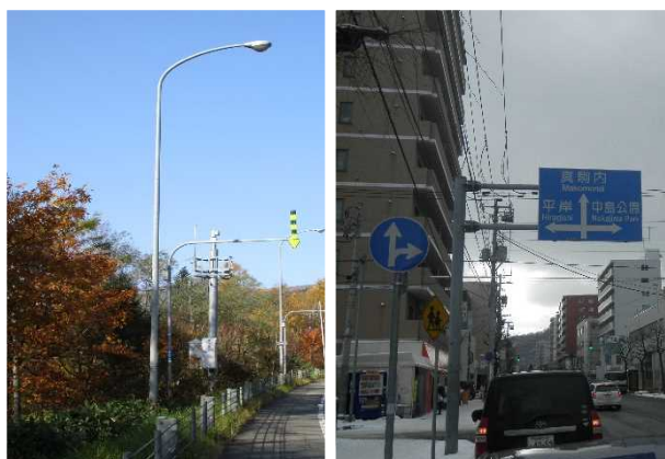
写真-1 道路照明(左)及び道路標識(右)
