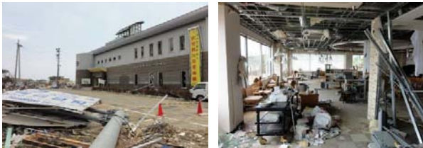
写真-1 「大谷海岸」の被災状況（右：2F内部）
