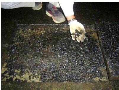
写真-1 水分の浸入による基層のはく離
