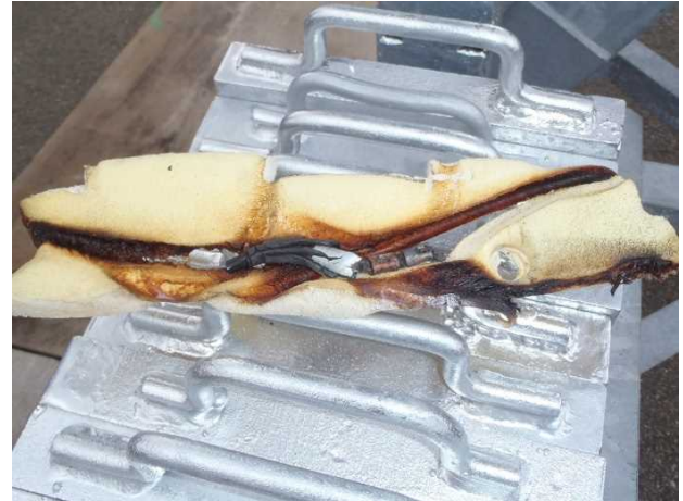
図-6 焼損した配線の状況
