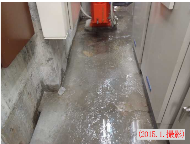
図-4 バルブ室内通路の凍結状況
