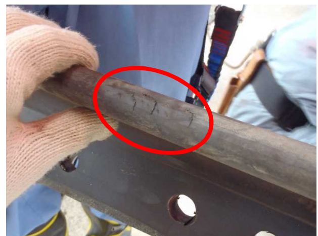
図-7 水密ゴムの劣化状況
