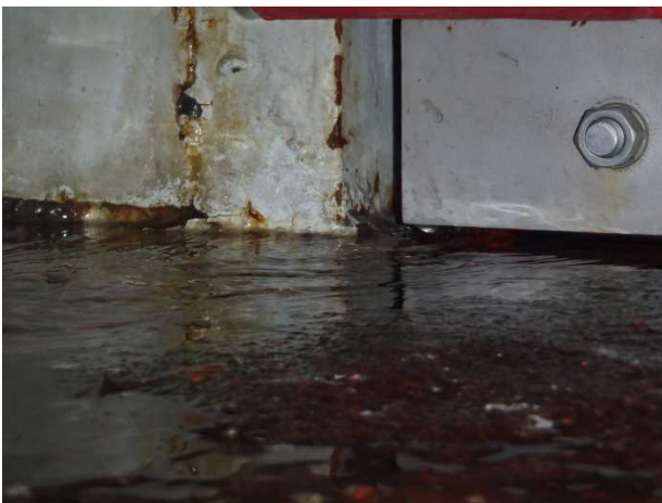
図-5 クレストゲートからの漏水状況
