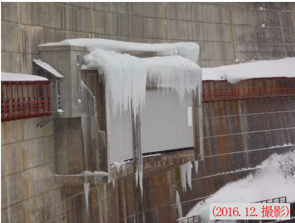
図-3 バルブ室上部の氷柱発生状況
