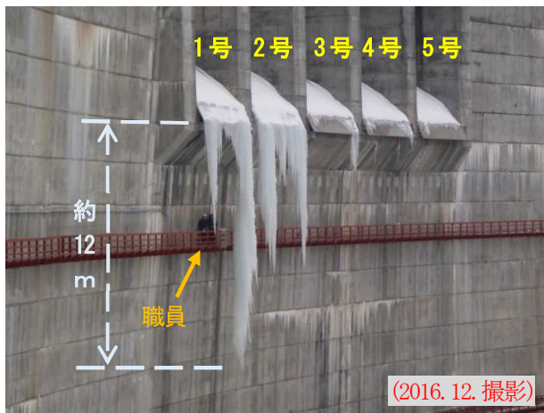
図-1 クレストゲート下流面端部の氷柱発生状況
