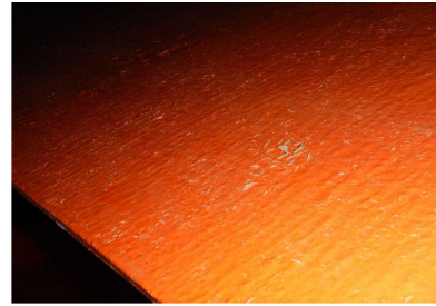
写真-3 塗装表面の割れ・剥がれ (B 工法)
