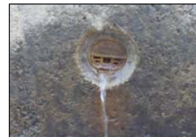
写真-23 流出状況
