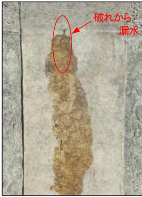
写真-9 ハンチ部漏水
