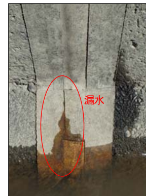
写真-14 ハンチ部漏水
