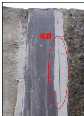
写真-16 樹脂の亀裂
