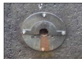
写真-18 流出未確認
