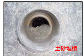
写真-24 堆砂状況
