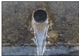
写真-21 流出状況
