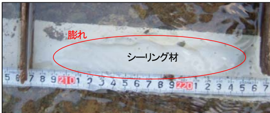
写真-1 シーリング材の膨れ状況 (施工直後)
