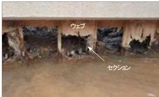
写真二 ウェブ部の開口と背面土砂流亡
