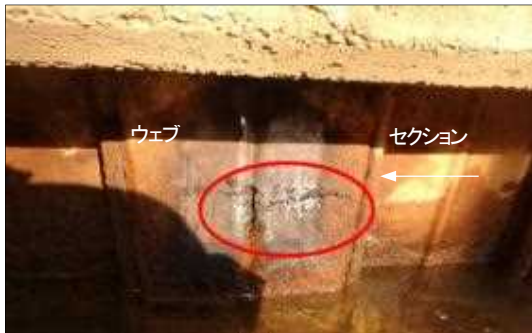
写真一 ウェブ部の横割れ
