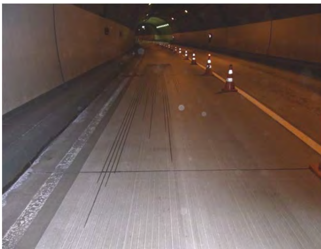
写真-14 シール材に溝があるため Co 版を超えて水は流れる
