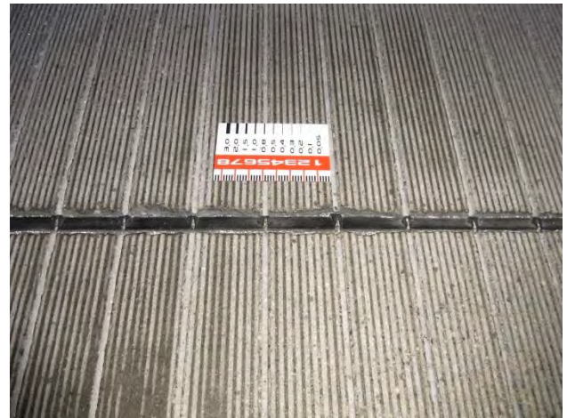
図-15 溝が切られたシール材部分
