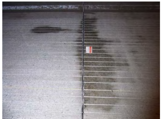
写真-11 Co 版端部の沈下による削り残り
