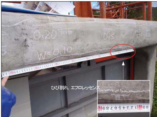
写真-9 B工法の張出スラブ側面の状態
