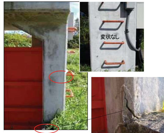
写真-5 A工法の門柱の状態
