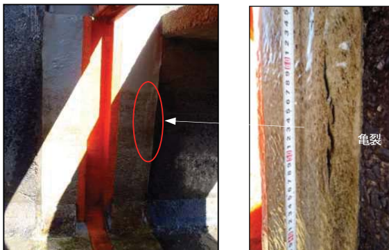
写真-10 C工法の門柱戸当たり付近の亀裂
