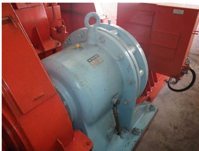
図-10 開閉装置減速機
