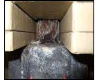
写-5 ソケット口元部の発錆状況
