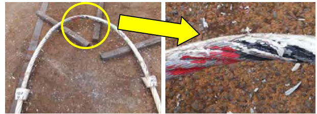
写-17 鞍掛部のロープ状態
