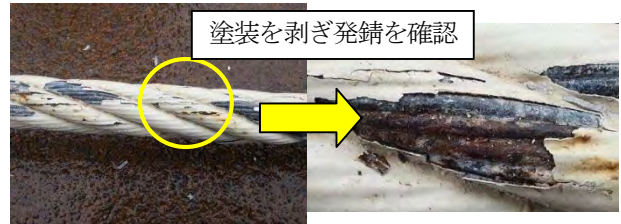
写-16 一般部塗膜異常箇所ロープ状態
