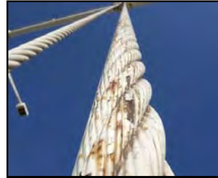
写-4 ロープ一般部の発錆状況
