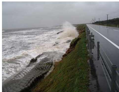
写真-5 被害事例3 C地区
