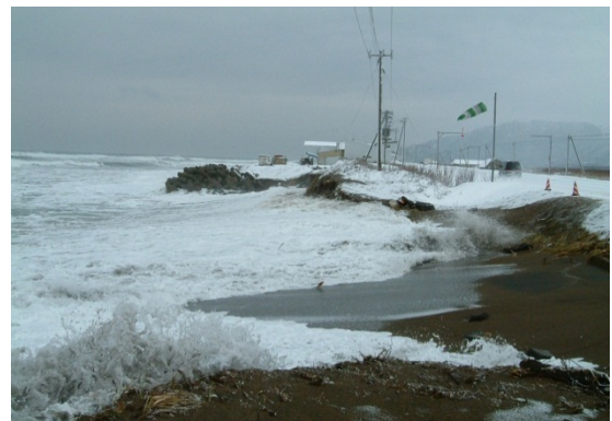
写真-1 国道への高波遡上事例（宗谷地方沿岸国道）
