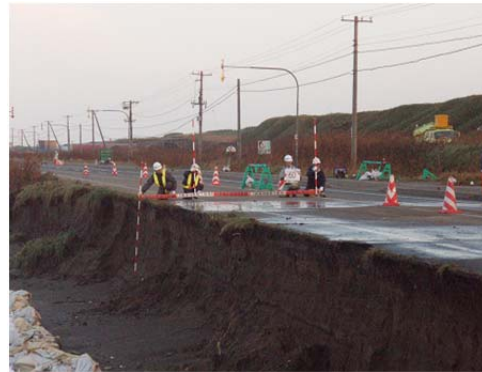
写真-4 被害事例2 B地区
