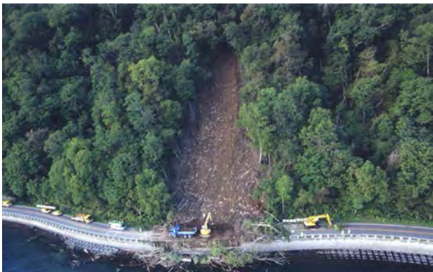
写真-1 H17.9に発生した表層崩壊
