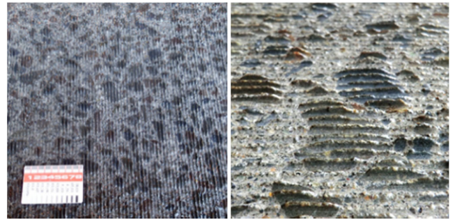
写真-1 ダイヤモンドカッタによる表面研削の仕上がり路面とフィン（背びれ）状の凹凸の例
