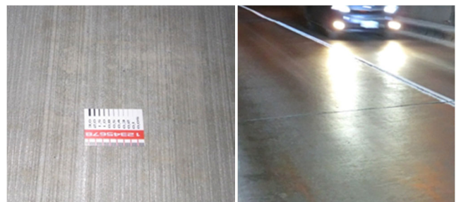
写真-2 施工直後のほうき目仕上げ（左）と供用に伴い光沢を帯びたコンクリート舗装路面（右）
