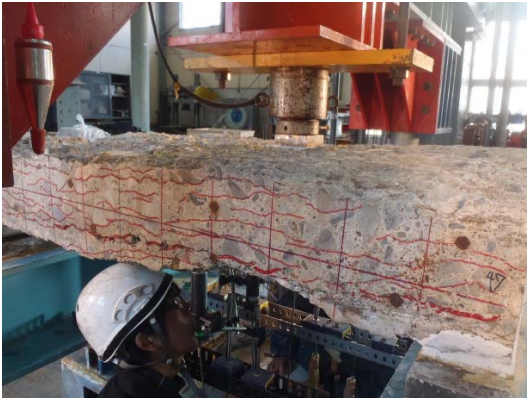
写真—2 ASRによる床版の損傷状況
