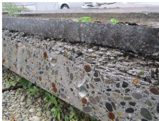
写真—1 凍害による損傷床版
