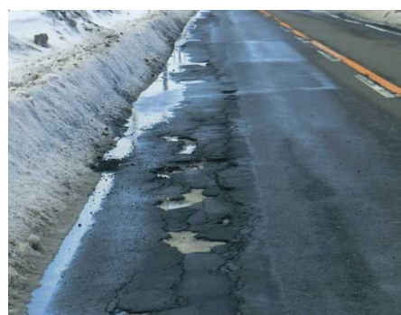
写真-2 ポットホール
