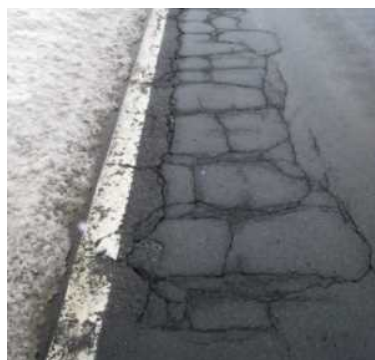
写真-1 融解期の支持力低下によるひび割れ
