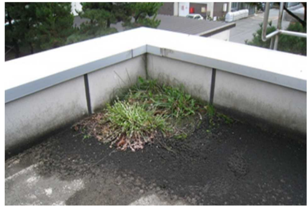
写真5 指導事例 屋上の清掃不良
