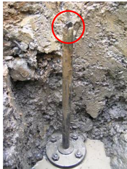
写真-2 漏水状況 (履歴番号②)
