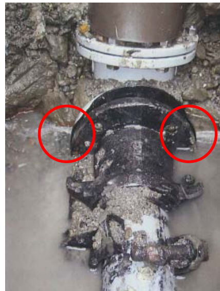
写真-4 漏水状況 (履歴番号④)
