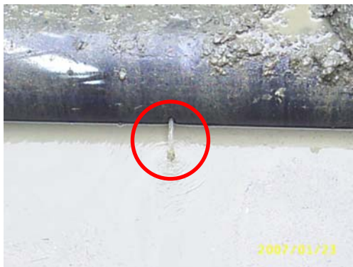
写真-1 漏水状況 (履歴番号⑥)
