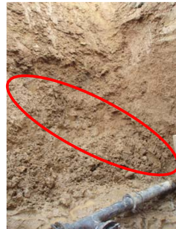
写真-9 地下水の浸み出し
