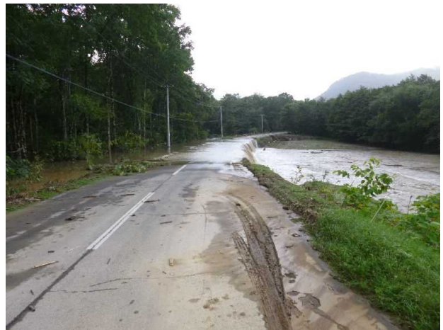
写真-1 美生ダムへアクセスする町道の状況
