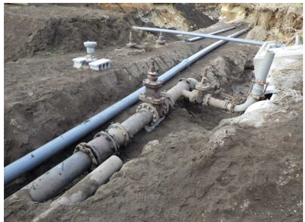
写真-6 応急本工事における用水路復旧の施工状況 (写真-4 同一地点)
