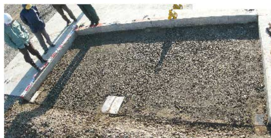
写真-4 液状化後の路盤上面
