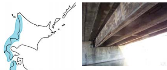
図-8 塩害損傷状況
