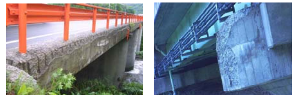
図-7 凍害損傷状況
