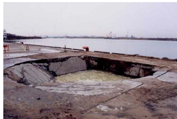
図-11 苫小牧港勇払地区-12m岸壁陥没状況
