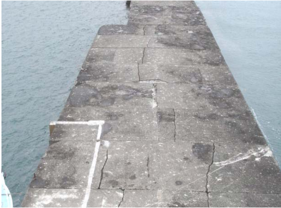
図-12 小樽港北副防波堤上部クラック発生状況
