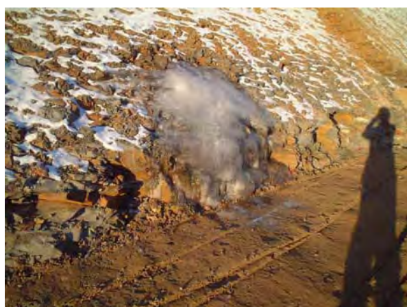
写真-4 凍上した切土法面
