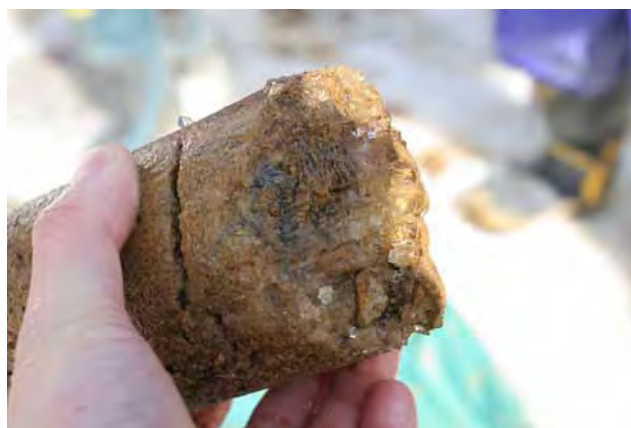
写真-5 凍上した法面から採取したコア
