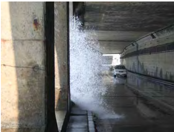
写真-2 覆道開口部からの越波状況
