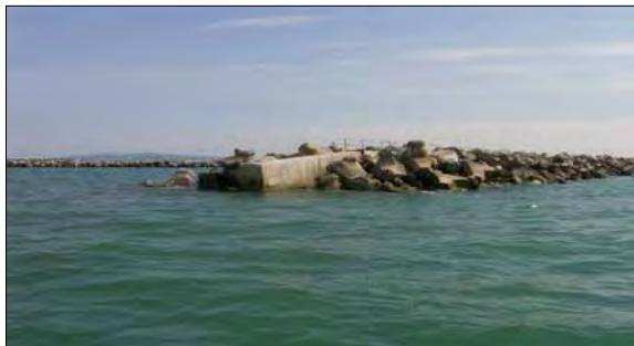
写真-3 防砂堤補修前状況写真
