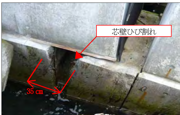
写真-2 芯壁ひび割れ
