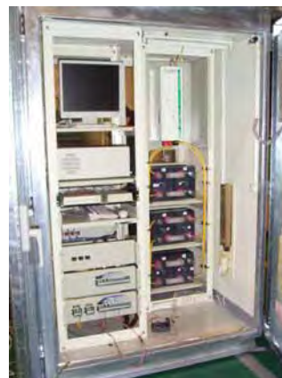
データ伝送装置 (受電点側設備)
