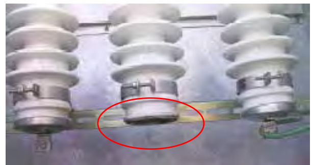
避雷器の破損状況
