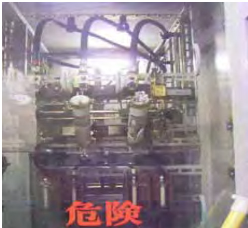
破損した LBS の状況
