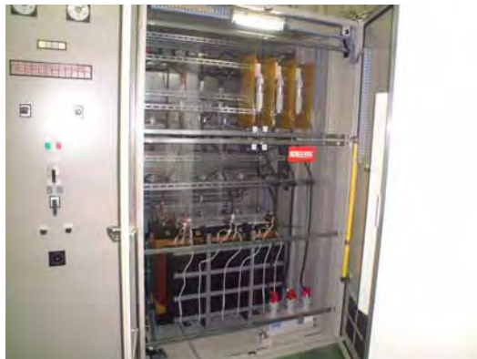
インパルス 70kV 高圧耐雷トランス設置状況
